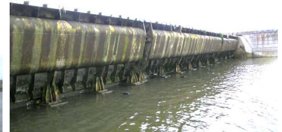
洪水吐ゲート (下流より望む)
