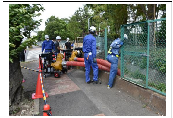
調布市排水ポンプ準備状況
