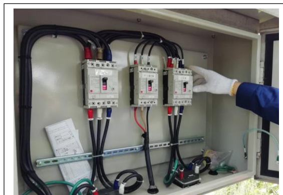
狛江市排水ポンプ稼動スイッチ確認
