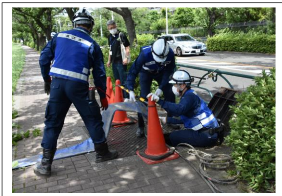
狛江市排水ポンプ準備状況
