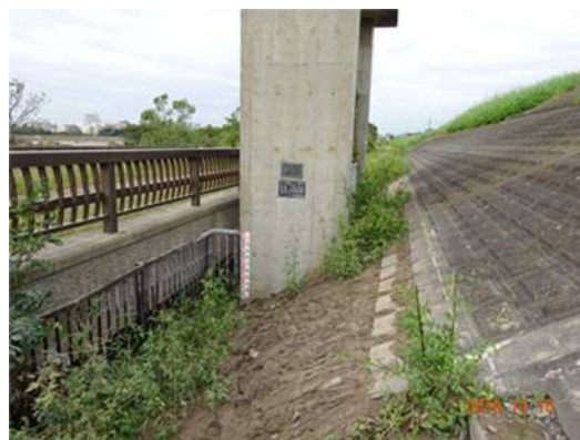
写真 2 猪方排水樋管水位痕跡
