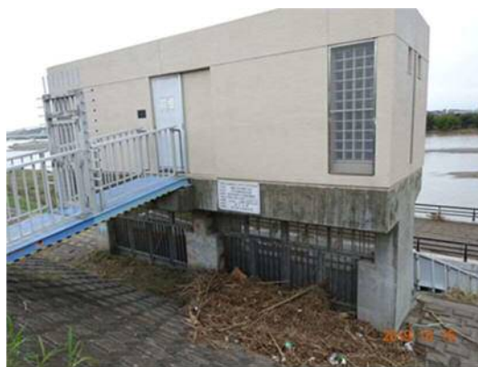
写真 4 六郷排水樋管水位痕跡
