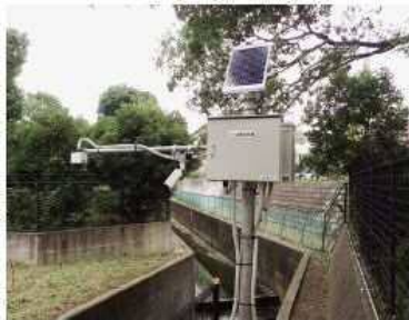
六郷排水樋管根川水位計および監視カメラ
