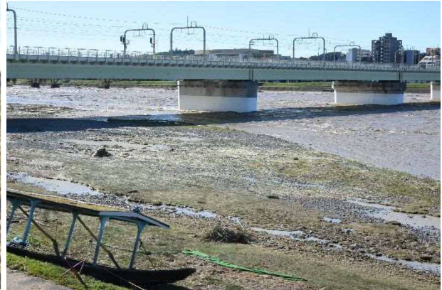
ドッグラン付近の被害状況 (東和泉四丁目 9 番先から小田急多摩川橋梁方向を撮影)
