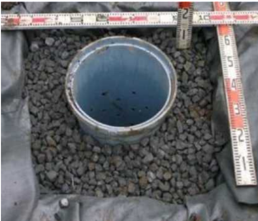
宅地内 雨水浸透ます
