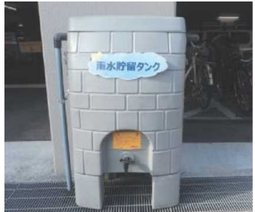
雨水貯留タンク
